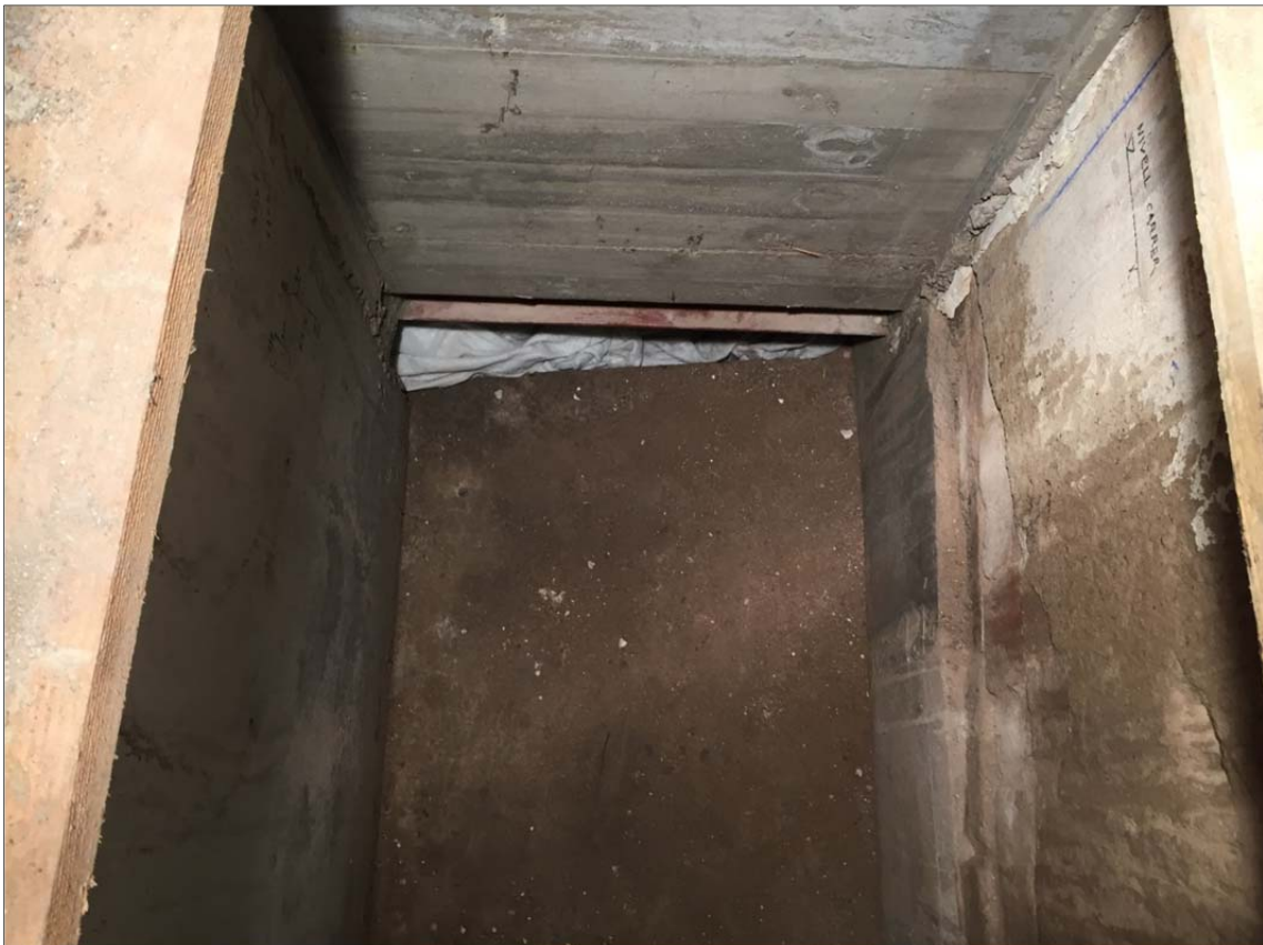
Foto 10. Vista zenital del fossat de l'ascensor amb el mur UE 06 i el seu cobriment amb malla de geotèxtil
